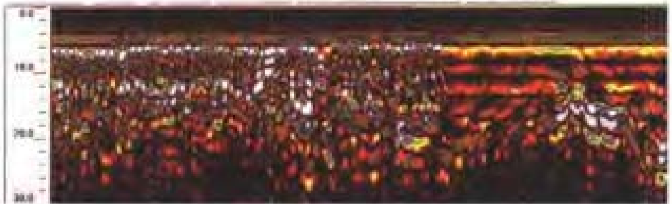
图 7.15 钢筋混凝土衬砌，背后不密实
